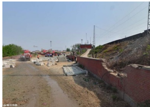
5.2 围墙、围栏破损
