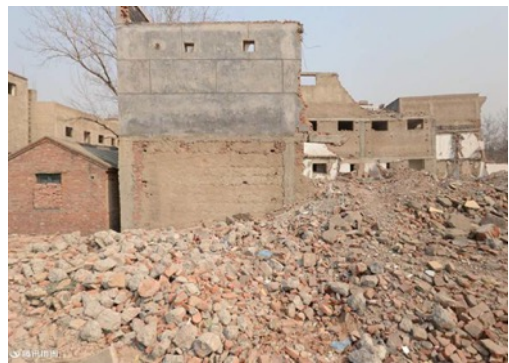
1.2 建筑结构破损
