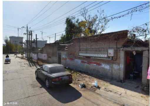
1.4 建筑立面污损
