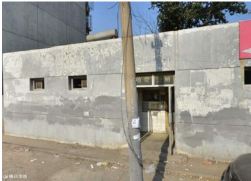
1.3 建筑立面破损
