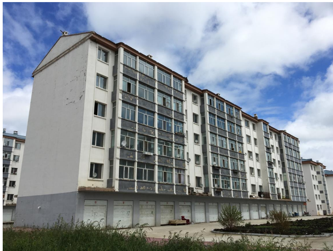
某新建棚改小区：外墙缺少维护已大面积剥落
